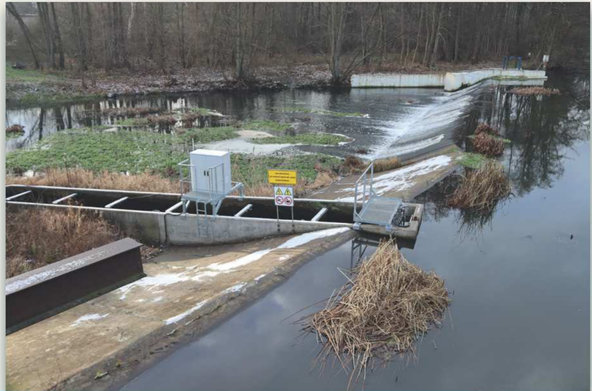
15.1. Przepławka z zamontowanym systemem monitoringu ryb A fish ladder with an installed fish monitoring system
